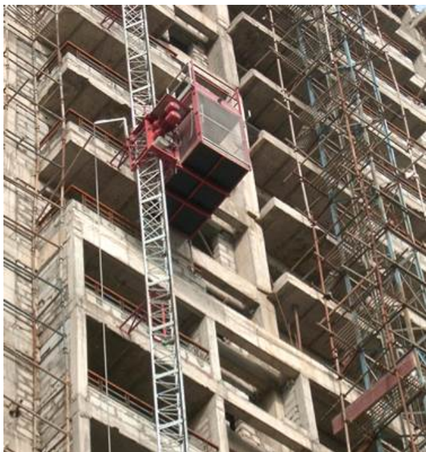
Fig. 6.3 – Esempio di montacarichi
